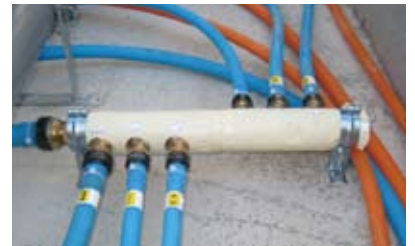
給水・給湯ヘッダー
